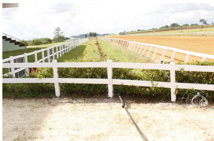
Novo cabeamento em fibra ótica
